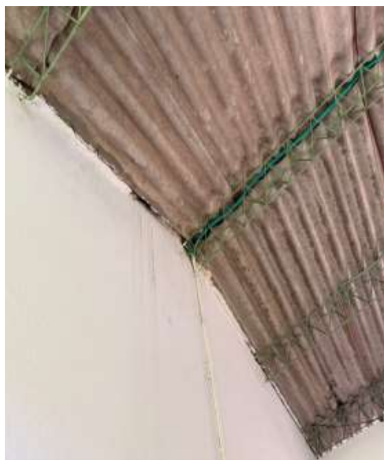
Coordinación Humedad por goteras. Sin luz
