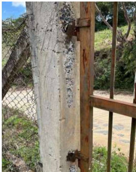
Figura 2. Deterioro en el soporte de concreto del portón.
