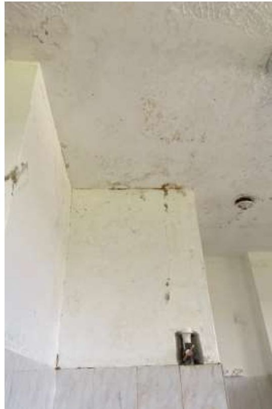
Humedad y filtración de agua en los baños.
