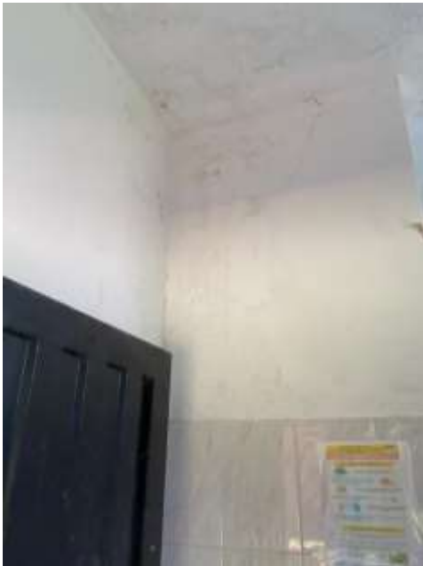
Humedad y filtración de agua en los baños.
